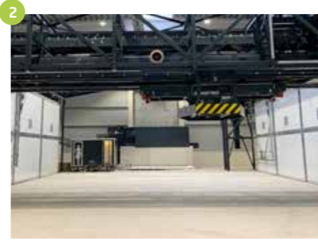
2 Kompostwerk mit Tunnelrotte und mechanischer Aufbereitung für Bioabfall, Grünabfall und Kompost Anröchte (DE) 43.000 Mg/a Baujahr 2020
