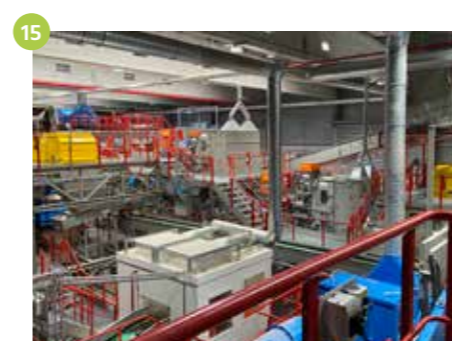
15 Sortieranlage für Leichtverpackungen Rostock (DE) 60.000 Mg/a Baujahr 2020
