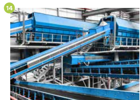
14 Mechanische Aufbereitungsanlage für Haushaltsabfälle Bargeddie (UK) 190.000 Mg/a Baujahr 2019
